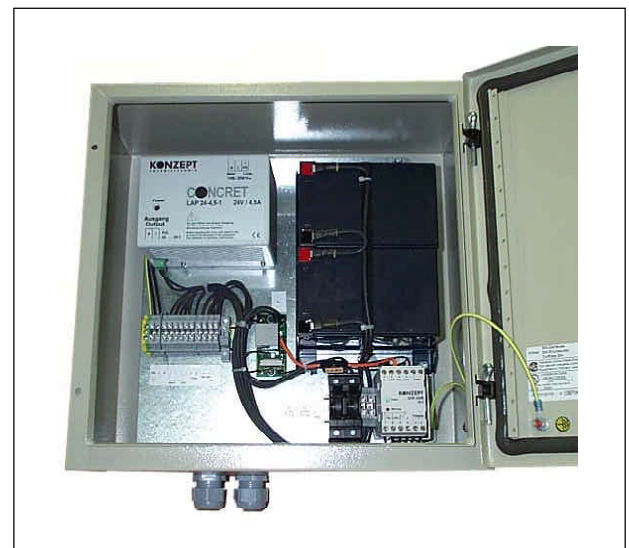
Fördersystemtechnik / conveyor system drive Nach Kundenwunsch / customer designed
