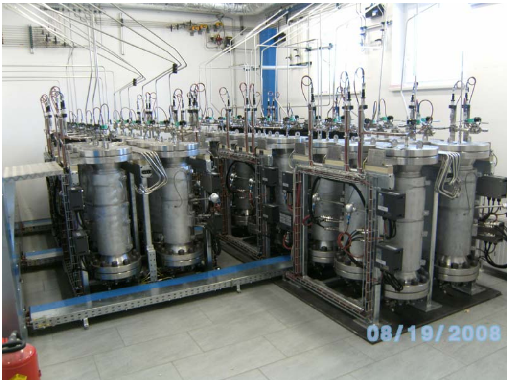
Gasreinigungsanlage nach Fertigstellung
