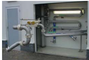
Bodenverladearm im verschließbaren Schutzraum montiert
